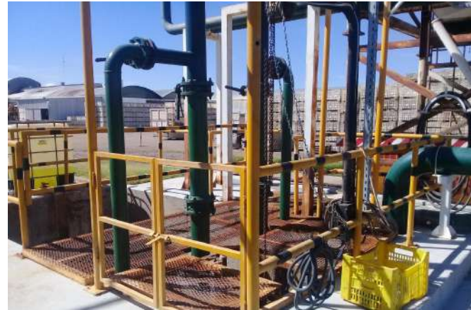
Sistema de tratamiento primario – Ind. Conservera – MENDOZA A riego de 80 Ha con Pasturas y vid
