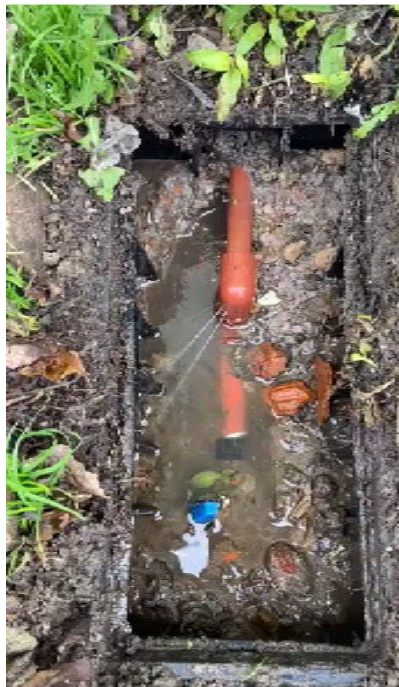
Conexión intervenida por el usuario Fuga - Materiales no homologados
