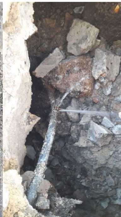
Fuga en tramo de conexión fraudulenta
